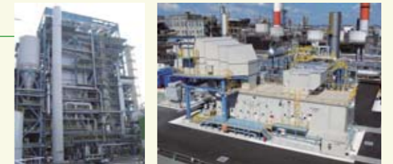
大竹工場 循環流動層ボイラー 網干工場 ガスタービンによるコジェネレーション設備
